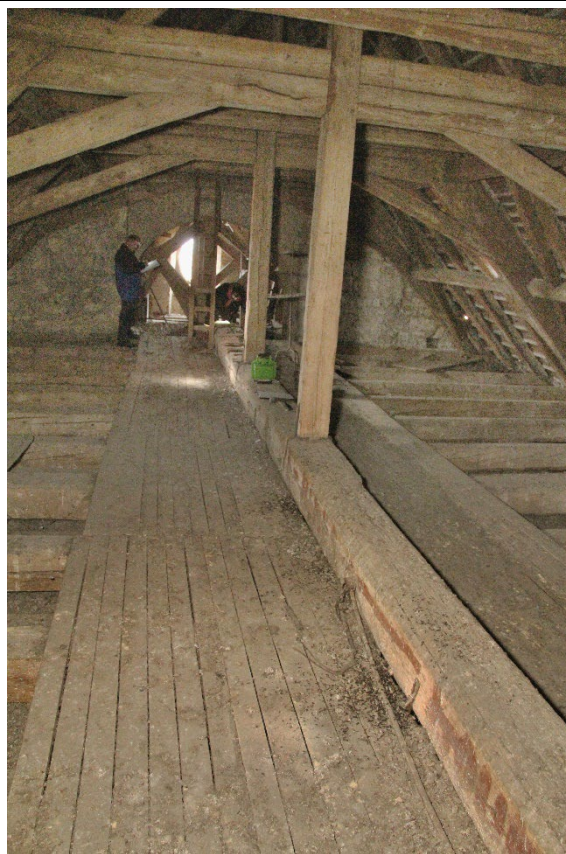
Střední průvlak krovu nad lodí v pohledu od východu. Foto: Jaroslav Skopec, 2018.
