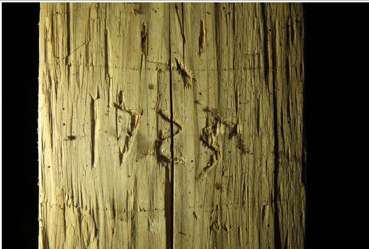
Detail letopočtu 1725 na věšadlovém sloupku druhé plné vazby od západu. Foto: Jaroslav Skopec, 2018.
