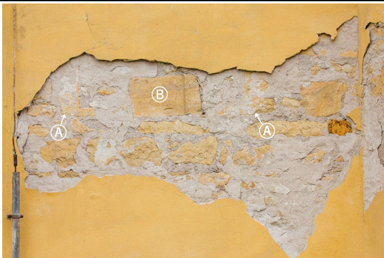
Detail odhalené části exteriérového zdiva východní strany závěru presbytáře. A – Stojky středověkého okenního otvoru. B – Druhotně použitý díl okenního ostění středověkého okenního otvoru. Foto: Marta Pavlíková, 2022.
