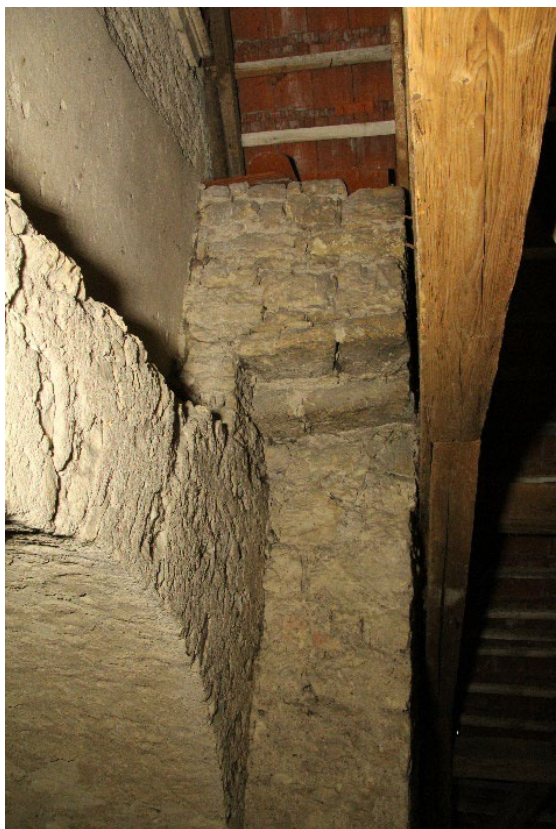
Severní strana východního průchodu věže z druhého patra do krovu. Foto: Jaroslav Skopec, 2018.
